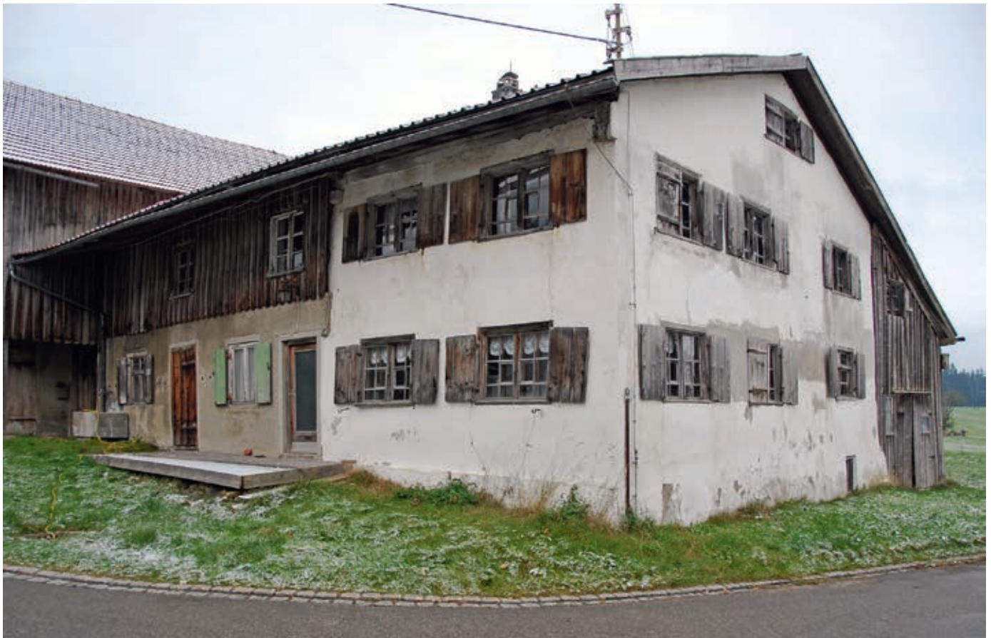
Buchenberg-Gablers, Lkr. Oberallgäu. Haus Nr. 181, Bauernhaus, Ansicht von Osten, Zustand vor der Instandsetzung (Foto: Franz Vogler, Oberstdorf)
